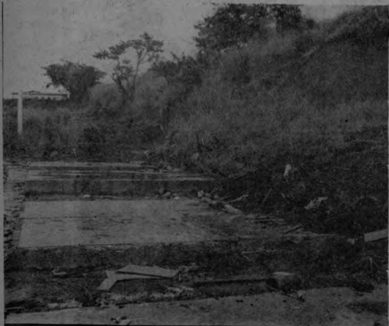
El terraplén, a la derecha, amenaza con derrumbarse. Al pie, parte de los cimientos de unas casas, que el IMAS se vio obligado a desarmar para llevarlas a otro sitio.
